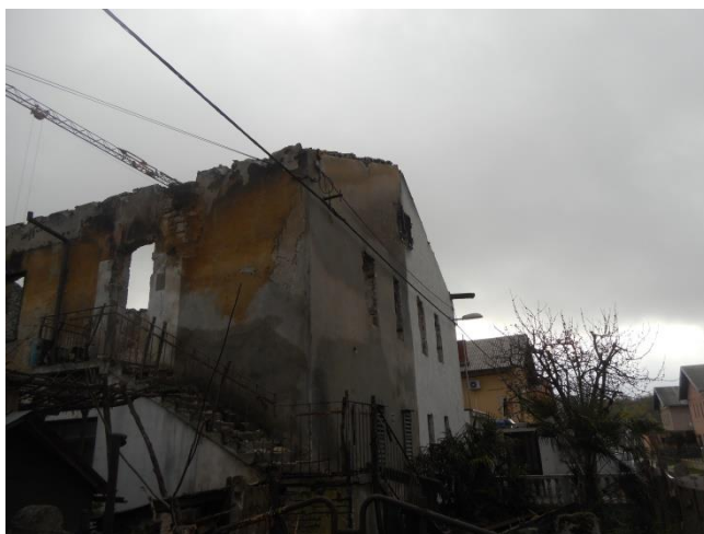
Vinež 168-186 nakon požara
